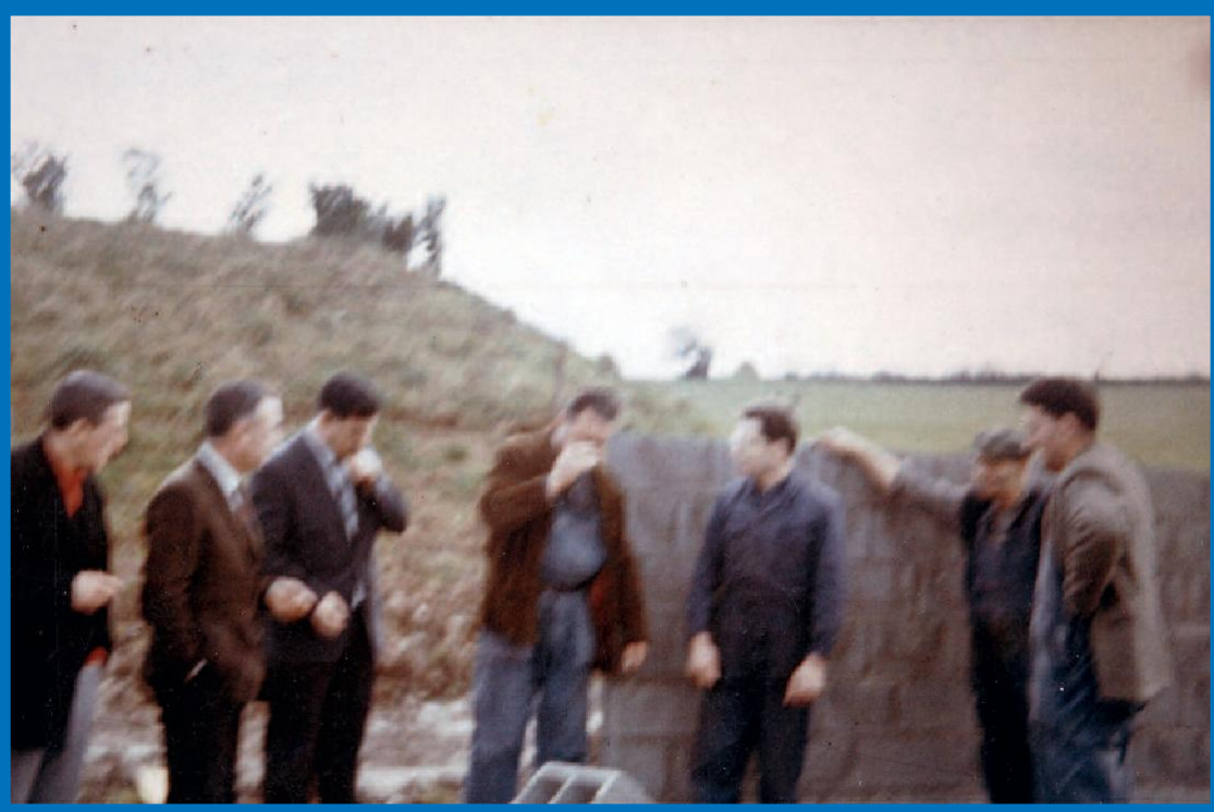
Le mur du fond s'écroule lors de la construction un incident qui aurait pu être une catastrophe...
